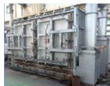
Li-ion電池 リサイクル設備
